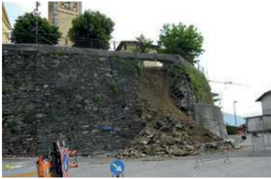
Fig. 2. Centa, chiesa di San Nicolò. Il muro di terrazzamento collassato (foto Walter Sadler).
